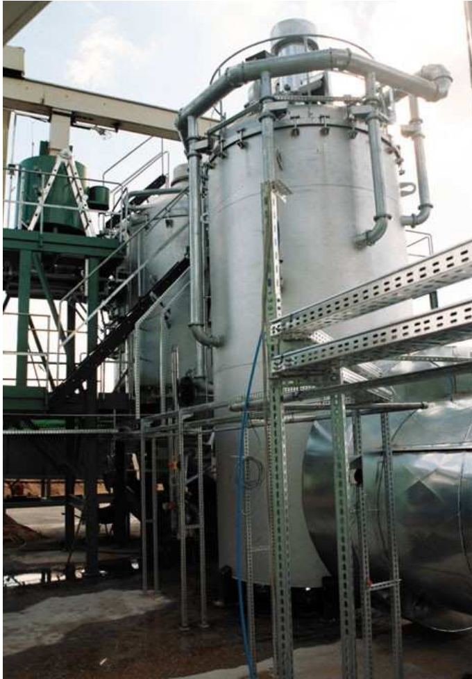
Komora spalania, z tyłu zgazowarka.
