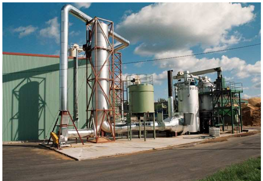
Komora zgazowania, spalania oraz suszarnia. Zakład w Szepietowie.
